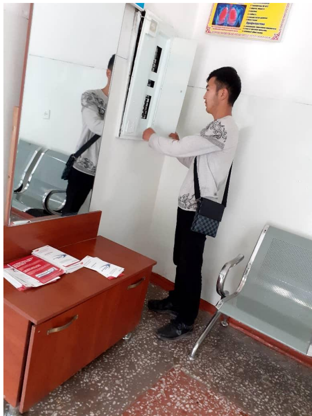
Проверка щитка в ЦСМ г. Ош
