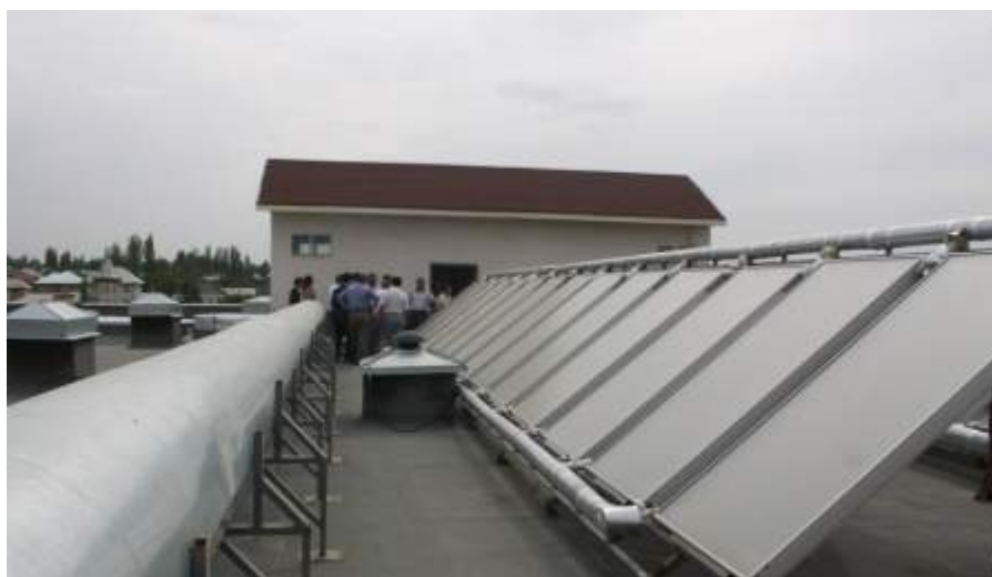
Рис. 1. Система солнечной энергии и горячего водоснабжения экспериментальной энергосберегающей школы №52 в мкр. Ак-Тилек г.Ош.
